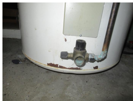
Rust på bereder indikerer tidvis vann i kjeller.
