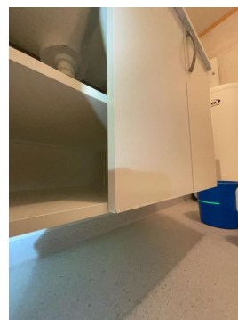
Svelling på dører til innredning
