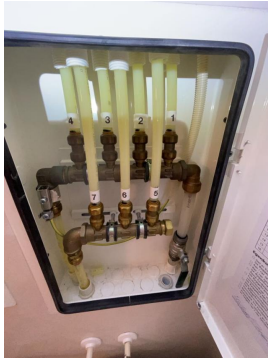
Veggskap med vannrør og stoppekran på bad
