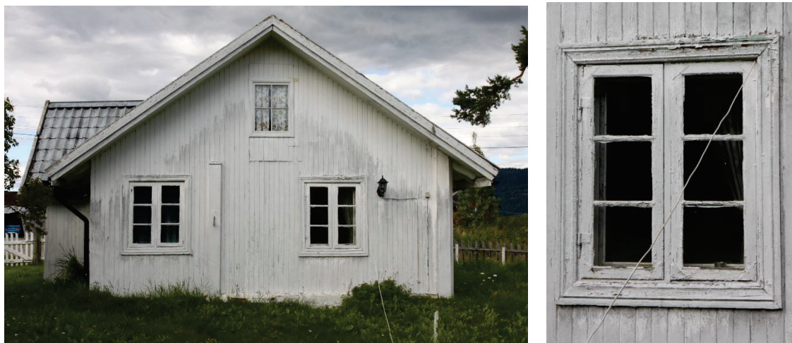
Bilde 12. Enkel fasade og vinduer i empirestil. Enkel vindusomramming. Avskalling av malingen tyder på vindusrammer hadde en annen farge enn fasade – typisk trekk for empirestilen.
