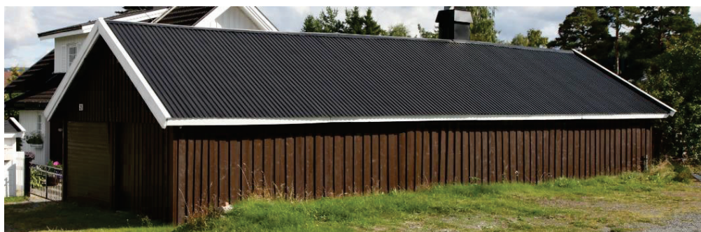
Bilde 8. Fasade mot veien har stående panel uten fasade elementer.
