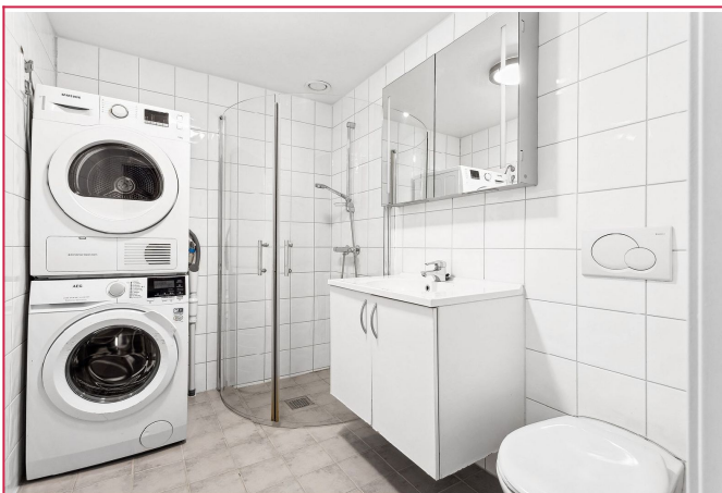
Bad med varme i gulv
