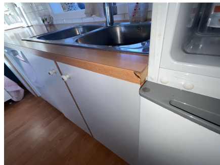
Skader i kantlist på benkeplate og det mangler kantlist mot kjøøl/fryseskap.
