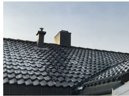
Det mangler pipehatt på pipeinndekning
