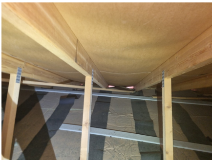
Synlig lufting sett fra kryploft mot raftekasse ved overgang tak/vegg
