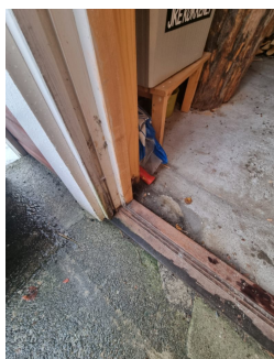
Synlig fuktinntregning på nedre hjørne av dørterskel på boddør
