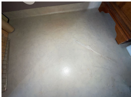
Merke/mykfuge i belegg inne på teknisk rom etter tidligere skade.
