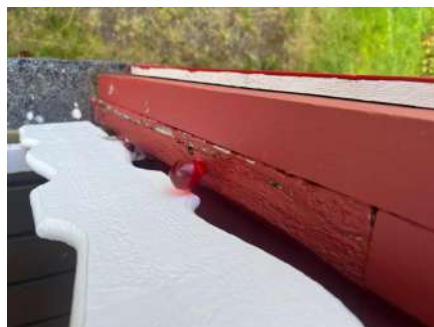
Råte i rekkverk stolpe.
