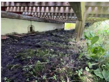
Fall i terreng mot bygning. Ventil nært terreng. Søyle som er skjev.
