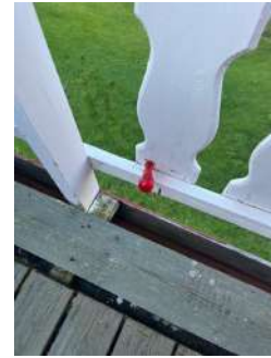
Råteskade i rekkverksbord og lekter.
