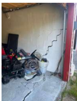
Gavlvegg med skrå sprekk er symptom på jordtrykk.
