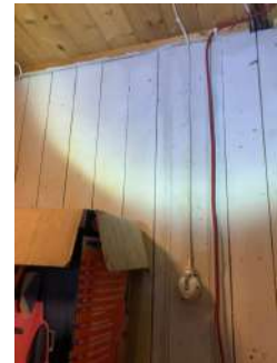
Gammelt anlegg fra byggeår uten gjennomført kontroll og skjøteledning som heller ikke er tilstrekkelig festet.
