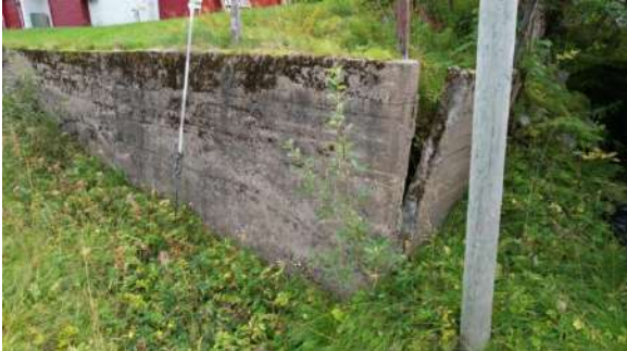
Mur er sprukket og skjev.
