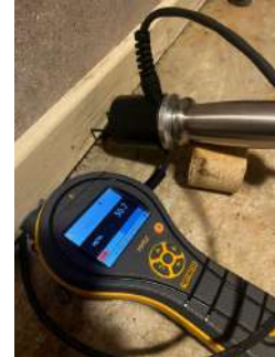
30,7% vannekvivalenter målt med pigg i trefiberplate. List er synlig fuktskadet.
