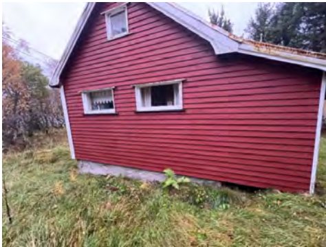
Ingen synlige ventilåpninger på oppholdsrom
