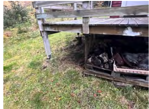
Svekket understøttelse av veranda.
