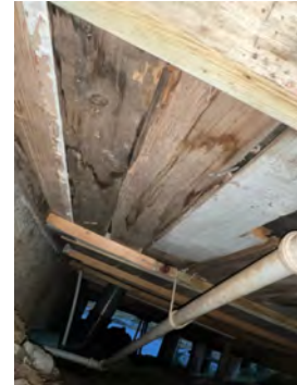
Fuktmerker i åpent kryperom.
