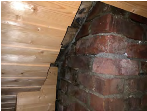
Målt fuktig treverk rundt pipeløp
