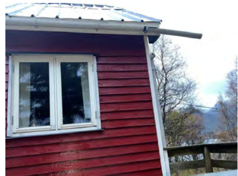
En del råte på kledning
