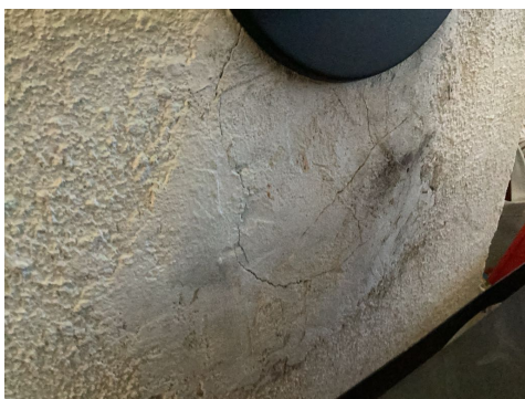
Eksempel på riss/ sprekke
