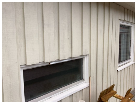
Eksempel på manglende beslag
