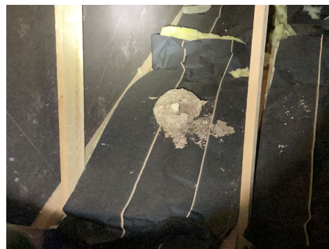
Rester av vepsebol. Loftsrom bør kontrolleres.
