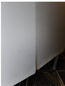
Fuktskader på dører i underskap servantinnredning
