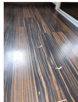
Overflate skader på laminatgulv.
