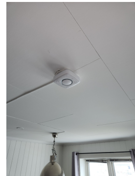
Sentralt brannvarslings system installert i bygningen.
