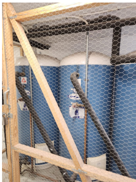
Felles varmtvannsberedere plassert i kjelleren i bygget
