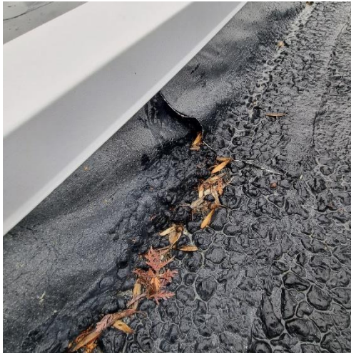
Her er tydelig lekkasje.
