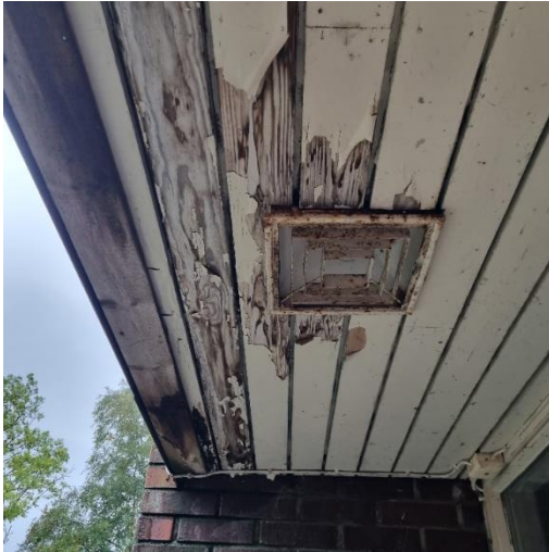
Råteskade pga lekkase i tak
