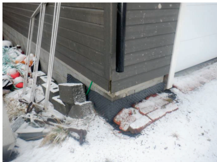
Utkast mangler på taknedløp.
