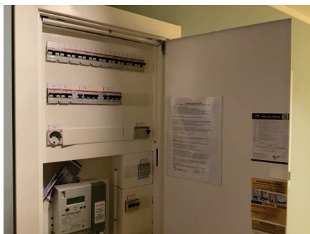
Sikringsskap med automatsikringer.
