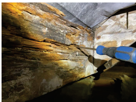
Råte avdekkes i yttertakkonstruksjon.
