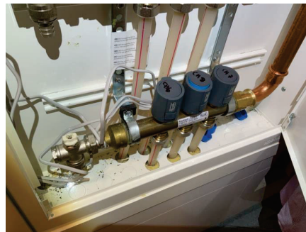
Utettheter rundt rørgjennomføringer i fordelerskap.
