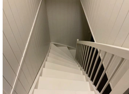
Trappeløp til underetasje håndløper mangler.
