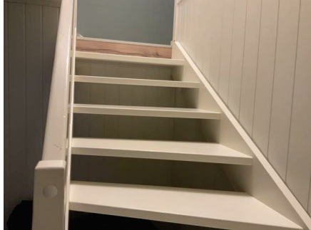
For stor åpning mellom opptrinn.
