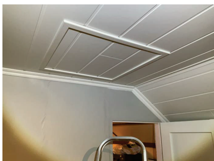
Uisolert takluke til kaldloft.
