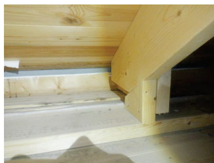
Ufagmessig utførelse ute langs takfot over garasje.
