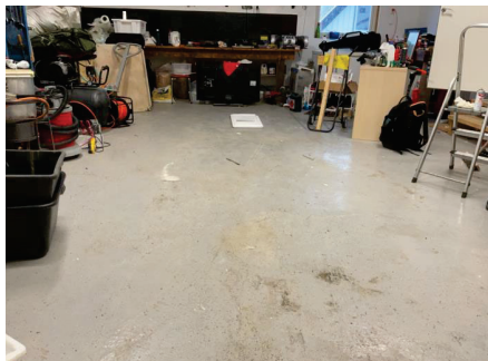
Flatt gulv uten tilstrekkelig fall for avrenning av smeltevann.
