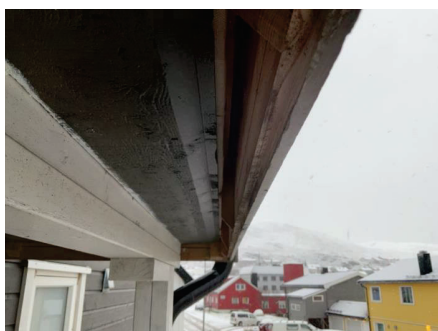
Ingen musesperre i nedre kant av konstruksjon.
