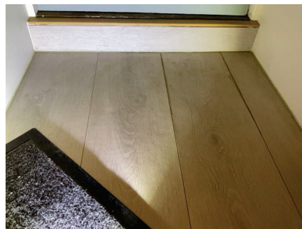
Skade/-svelling i langsgående parkettskjøt ved ytterdør.
