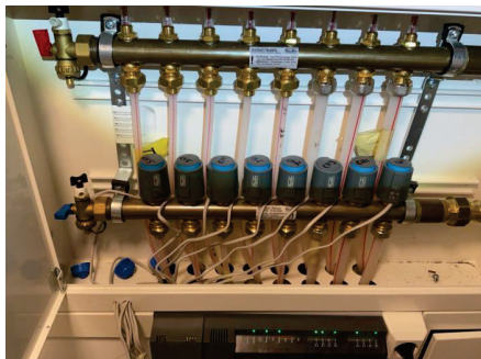
Utettheter rundt rørgjennomføringer i fordelerskap.
