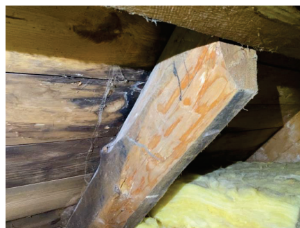
Misfarging og fuktutslag i taktro.
