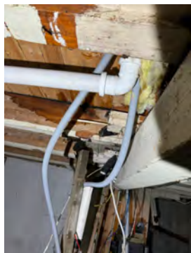
Fukt i etasjeskiller etter vannlekkasje på kjøkken.
