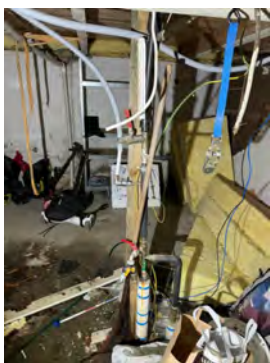
Ufagmessig utførelse av vannledninger.
