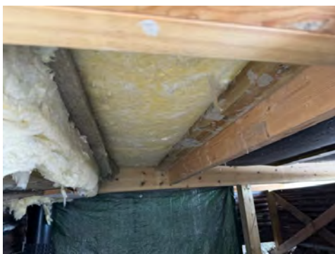
Manglende tetting under bjelkelag på tilbygg.
