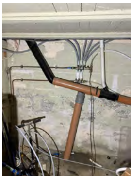
Ufagmessig utførelse av vannledninger.
