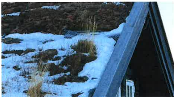
Bilde viser deler av taktekkingen, men stedvis manglende torv.
