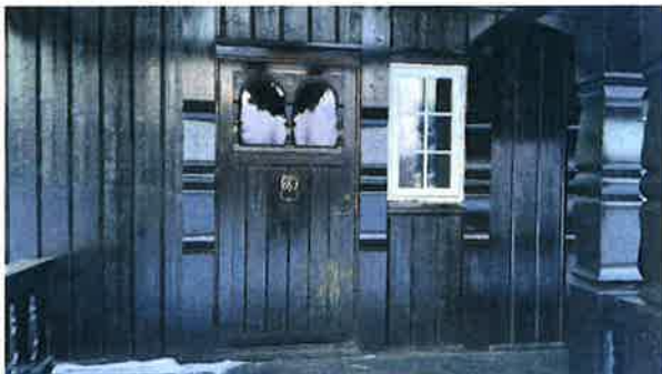
Bilde viser ytterdør med behov for overflatebehandling.
