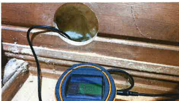
Bilde viser måling i tilstøtende vegg mot våtsone.
