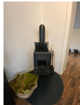
Bildet viser vedfyringsovn, plassert i stuen.
