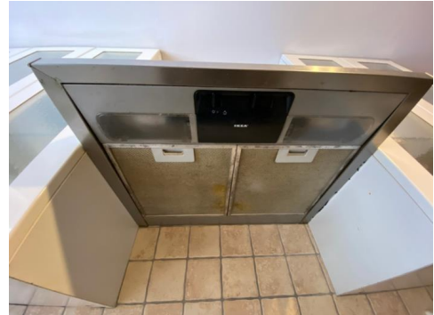
Bildet viser IKEA ventilator med avtrekk ut.
