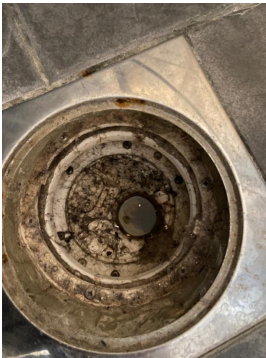
Bildet viser sluker på bad/vaskerom.
