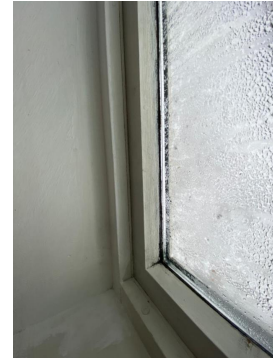
Bildet viser vindu med kondens og svertesopp.
