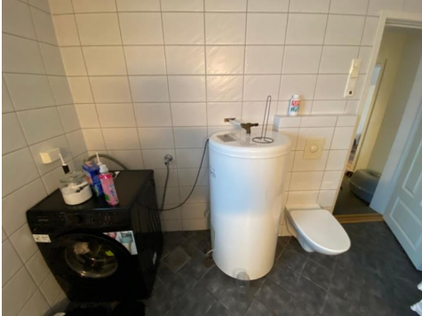
Bildet viser varmtvannstank på 200 liter, plassert på badet/vaskerommet.
