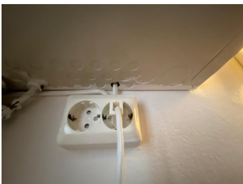
Bildet viser hull/kabelgjennomføring i sikringskapet.
