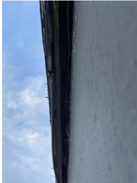
Bildet viser lite lufting i nerkant av kledning.
