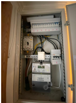
Bildet viser sikringskap med automatiske sikringer.
