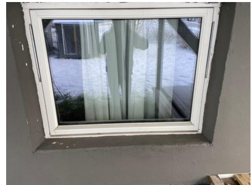
Bildet viser vindu med manglende beslagsløsning.
