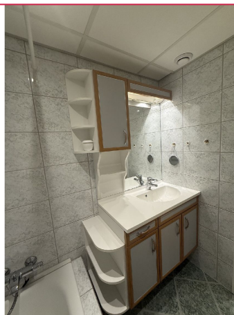
Bad med dusj og servant
