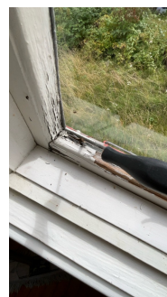
Det er påvist vinduer med fukt/råteskader.
