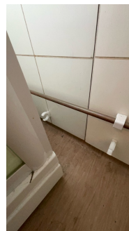
Fuktskade på yttervegg bak dusjkabinett.
