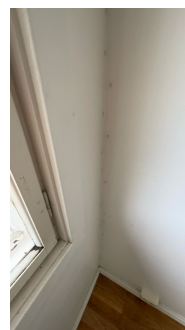
Det ble observert mørk missfarging på soverom. Anbefaler å undersøke dette nærmere. Dette kan for eksempel være "støv" eller heksesot. Mer info kan leses på https://hussoppen.no/skadevoldere/heksesot/
