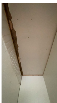
Manglende håndverksmessig utførelse på deler av arbeid.
