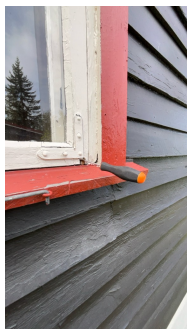
Det er påvist vinduer med fukt/råteskader.
