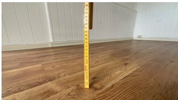
Helningsavvik på 15 mm ble målt i soverom mot nord i 1. etasje.
