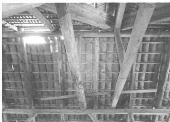
Vestre takflate med takstein, behov for utbedring av takteking
