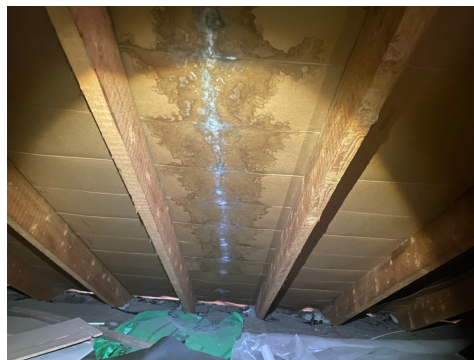
Bildet viser fuktmerker i undertak.
