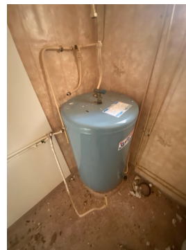
Bildet viser varmtvannsbereder.
