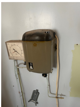
Bildet viser Dagtank/pumpe for oljefyr.
