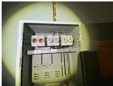
Bildet viser sikringsskap.
