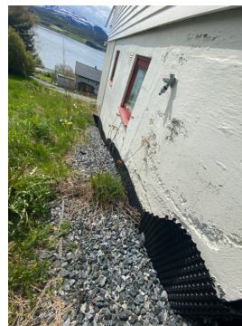
Bildet viser manglende klemplister.
