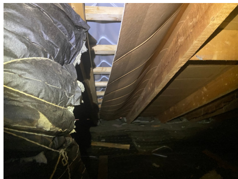
Bildet viser løst undertak.
