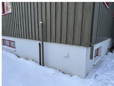
Utvendig røropplegg på østsiden av boligen
