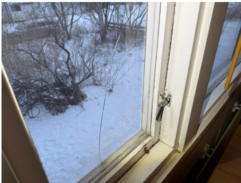
Sprukket glass i vindu på soverom
