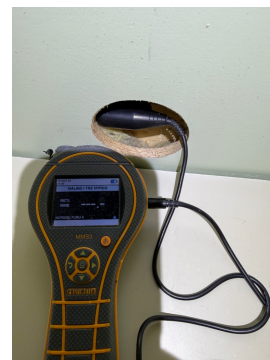
Fuktmåling i tilliggende konstruksjon bak badekaret
