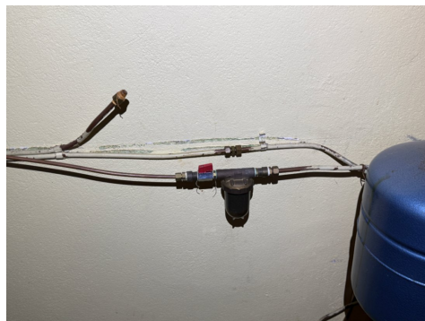
Innvendig røropplegg til fyrkjel
