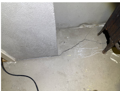
Sprekk i betonggulv ved vedovn i kjeller
