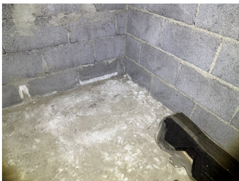
Saltutslag på vegg og gulv
