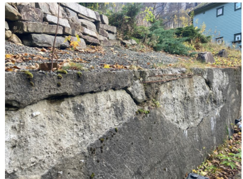
Skade i mur langs veg
