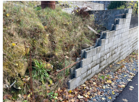
Påbegynt mur som ikke er ferdig. Oppstikkende armeringsjern
