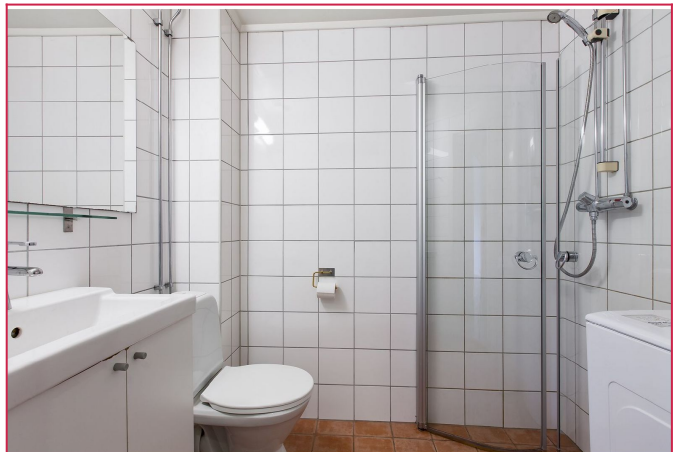
Flislagt badrom. Varmekablene fungerer ikke. Vaskemaskin medfølger.
