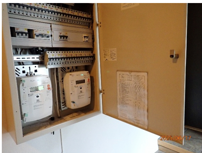
Fellesareal: Strømskap i fellesareal som kreves flyttet ved salg.
