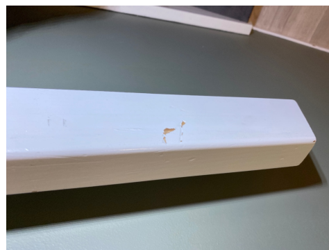
Skade overflate håndløper.
