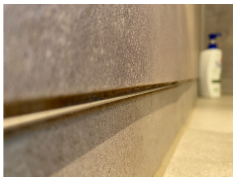
Fuging i nedkant på plater bør utbedres.
