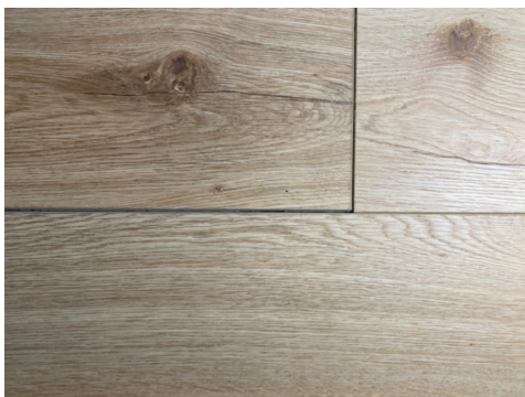
Laminatgulv har glipper i skjøter.
