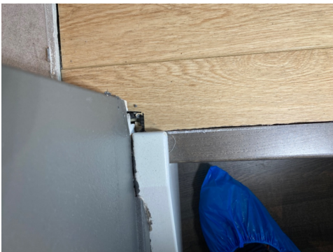
Manglende listverk mot trapp.
