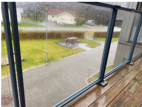
Ingen synlig CE-merking av glassrekkverk
