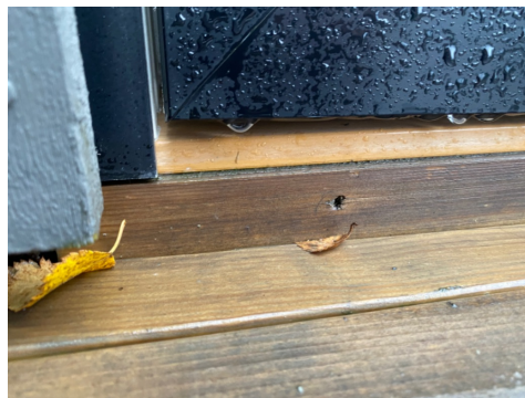
Manglende beslag i nedkant.
