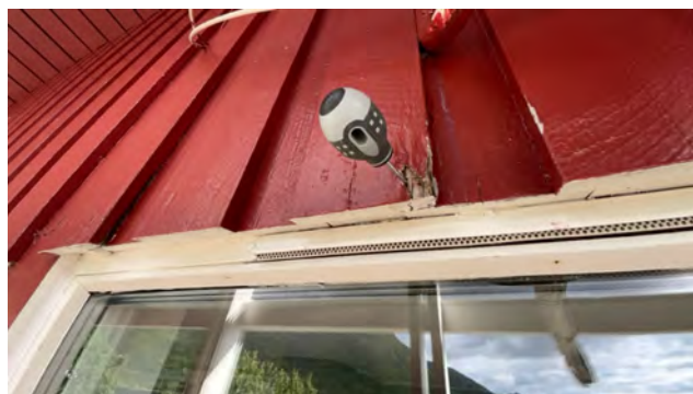
Utsnitt av kledning med råteskade.
