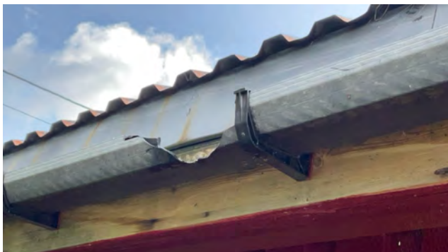
Takrenne med skade.
