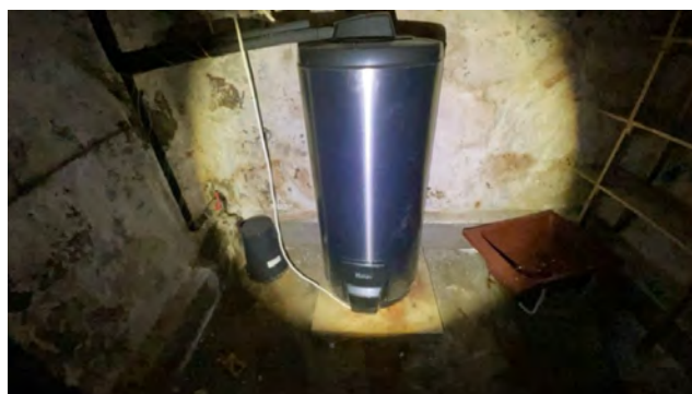
Varmtvannstank plassert i kjellerrom.
