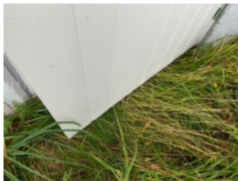
Fuktskade på nedre del
