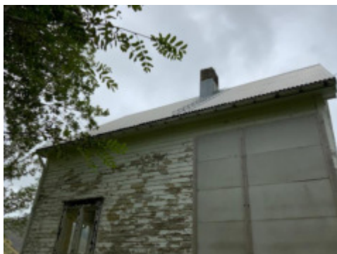
Litt deformasjoner på renner.
