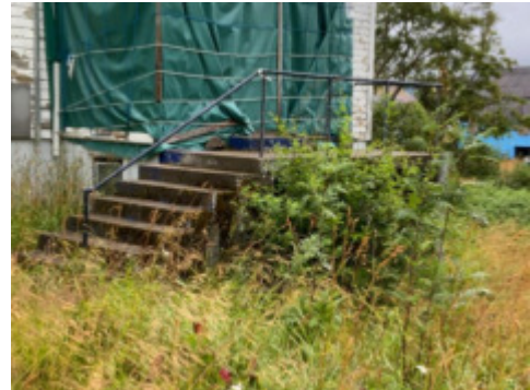
Utv betongtrapp med slitasje og påkostbehov.
