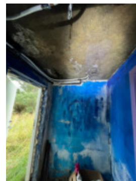
Stedvis fukt og råte i etasjeskiller (e)
