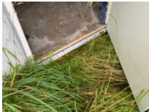
Mangler vannbrettbeslag over og under dør
