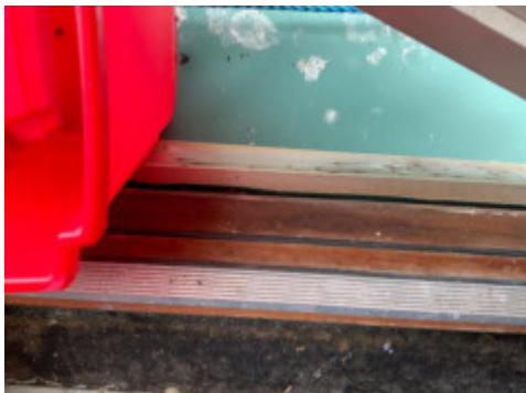
Mangler beslag under dør - alder og slitasje
