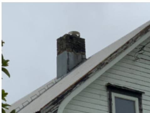
Pipe mangler beslag heldekkende.
