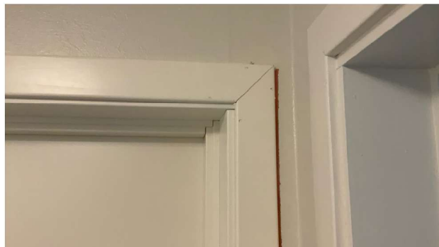
Manglende flikkarbeider ved inngangsdør
