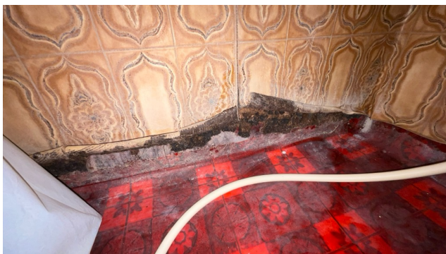
Fuktskade i veggplater
