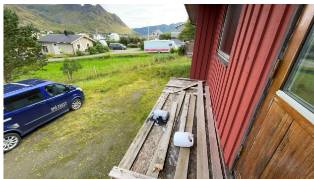
Luftbalkong mangler rekkverk
