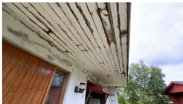
Luftbalkong har råteskader i bjelkelag
