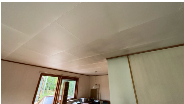
Sotskader i tak i stue
