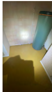
Fuktskader på vegg i bod med vv-bereder
