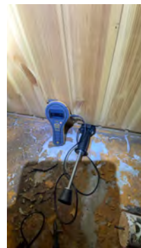
22,1 prosent fukt i svill bod innenfor pipe som gir vekst av mugg
