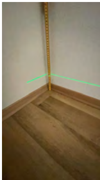
2,5 cm, skjevhet på soverom mot øst i 1 etasje
