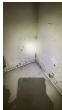
Fuktskader på synlige murvegger i kjeller
