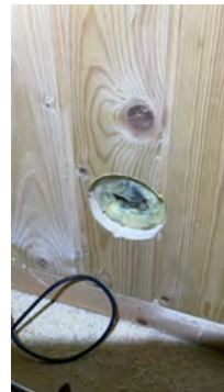
Plast mot grunn som er feil oppbygging.
