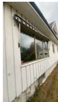
Flere vinduer i 1 etasje ser ut til og være punktert.
