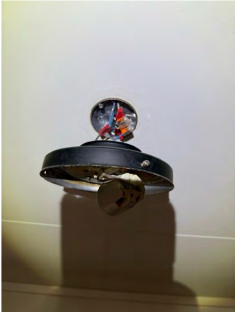
Bilde 2 Takboksen over takarmatur er fuktig.
