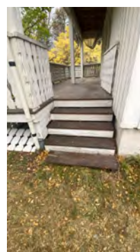
Mangler rekkverk på platt til stue.
