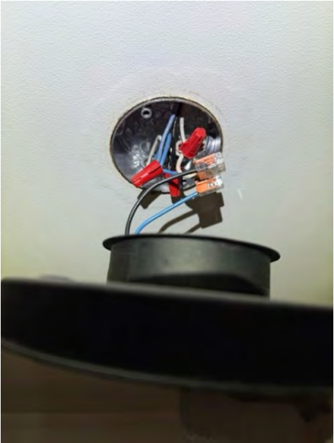
Bilde 1 Lekkasje vann har samlet seg ved takboks i stua 1. etg.
