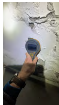
Høye utslag på vegger med indikasjonsmåler
