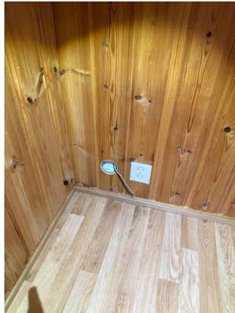
Bilde 2 Oppholdsrom i 2. etg. Åpen veggboks med løse ledninger ut av veggen. Mangler korrekt endeavslutning og dekklokk.
