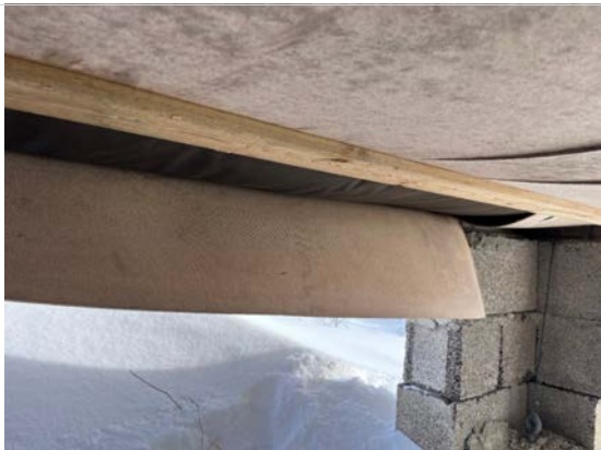
Stubbloftsplate har løsnet. Misfarge på stubbloftsplater
