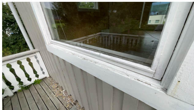
Vindu mangler beslag utvendig
