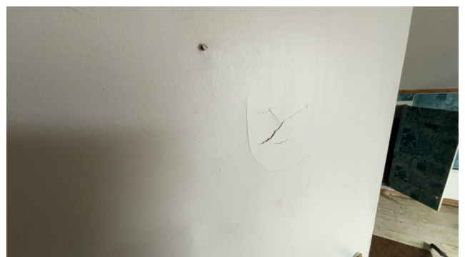
Skade i innerdør
