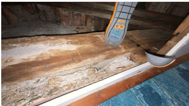
Fuktmåling med forhøyede verdier i fuktmerker ved takluke på kryploft ved pipe
