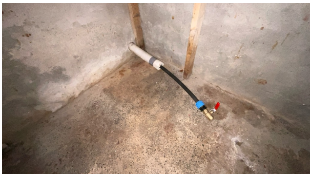
Vanninntak som ikke er tilkoblet boligens rørnett
