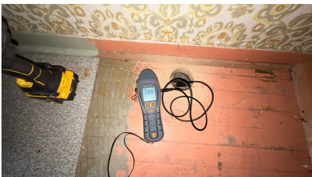
28% og forhøyet fuktutslag i oppforet tregulv i "kjellerstue" mot øst
