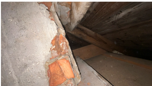
Fuktmerker rundt pipe
