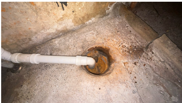
Støpejernsrør i kjellergulv og mest sannsynlig nedgravd utvendig
