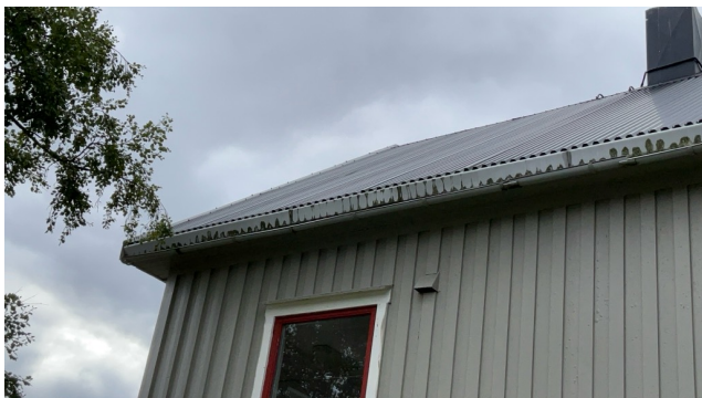
Tak har ikke snøstopperer eller takstige
