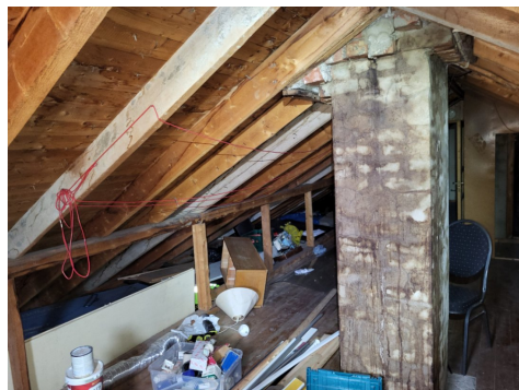
Det er påvist fuktskjolder/skader i takkonstruksjonen.
