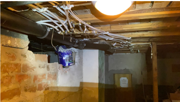
Plast ledninger i kjeller.
