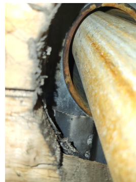
Det er påvist avvik rundt gjennomføringer i takflaten.
