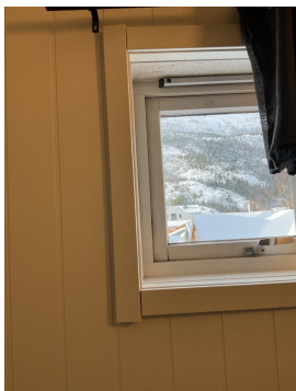
Kondenskader på vindu på bad.
