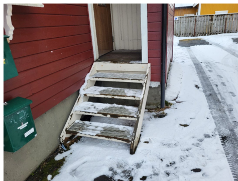
Utvendig trapp uten rekkverk.
