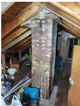
Utvendig sotvann på pipe på kaldloft
