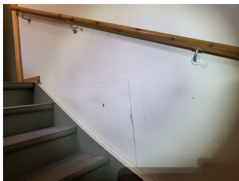
Skader på overflater i trapperom
