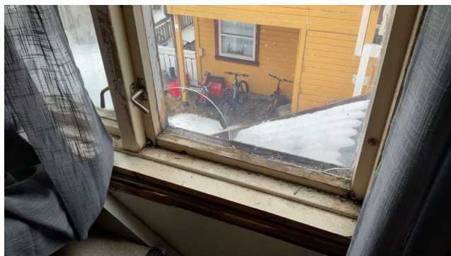
Fukt/råteskader på vindu i trapperom..
