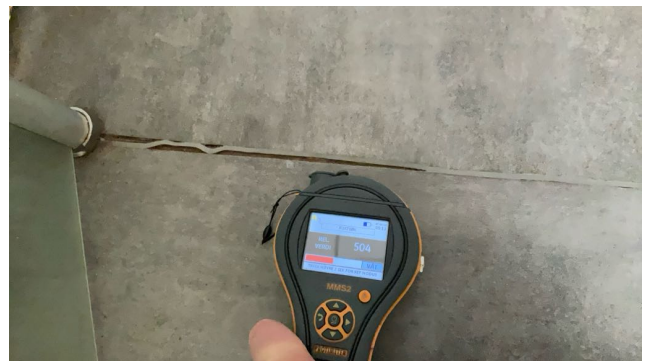
Fuktmåling på gulv ved glippe i belegg. Påvist fukt.
