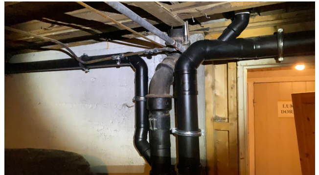
Blanding med soilrør og plastrør.
