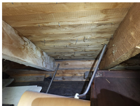
Ingen lufting ut over raft.
