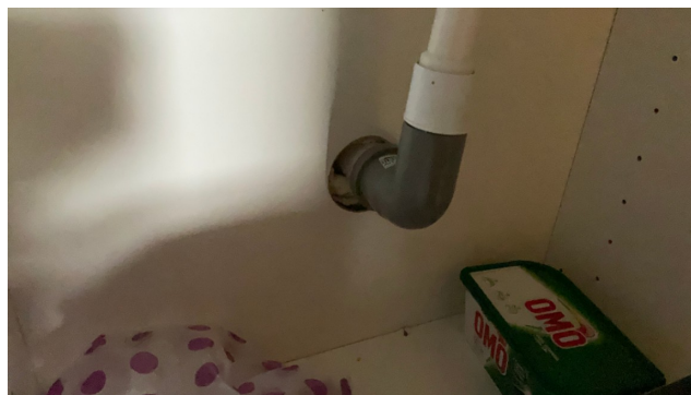
Manglende mansjett på avløpsrør inn i vegg.
