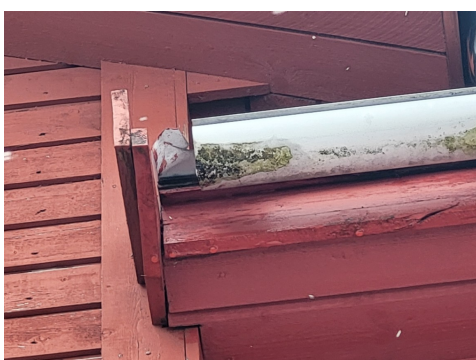
Manglende endelukk på renne over inngangsparti
