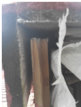
Manglende musesperre under hjørnebord.
