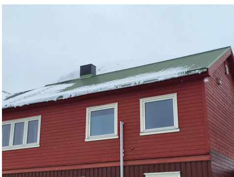
Manglende snøfangere mot vest.
