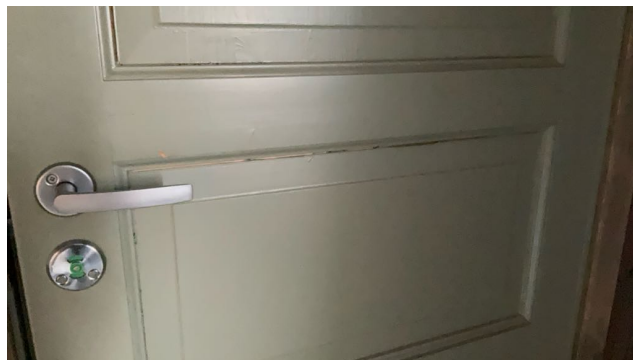
Små skader i overflater.
