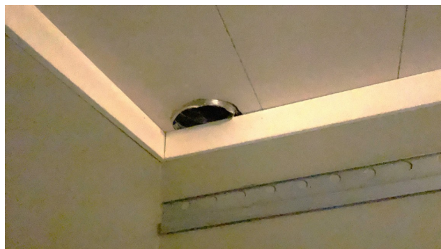
Åpent ventilasjonsrør som er kappet i himlingen.
