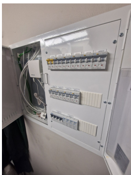
Automatsikringer og måler i sikringsskap.
