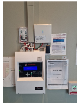
Felles brannvarsling i bygningen.
