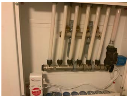
Waterguard montert i rørskap
