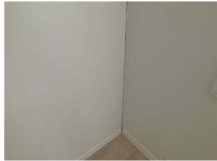
Sprekk i hjørne på vegg i spisestue.
