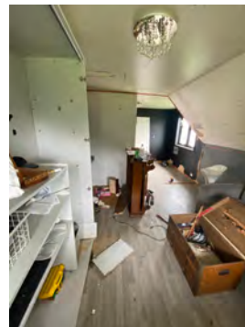
Bildet viser enkelte overflater med skade.
