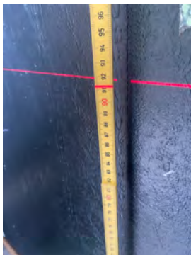
Bildet viser avvik målt i etasjeskille.
