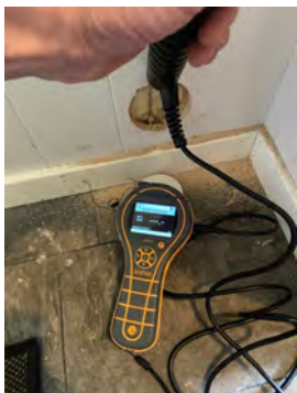
Bildet viser fuktmåling av bad fra 2013.
