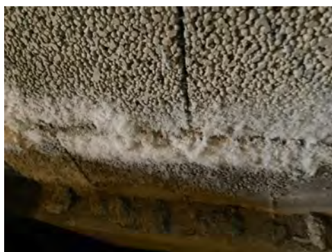
Bildet viser saltutslag.
