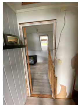
Bildet viser enkelte overflater med skade.
