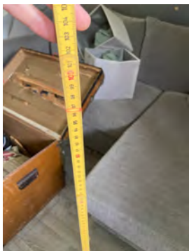
Bildet viser avvik målt i etasjeskille.
