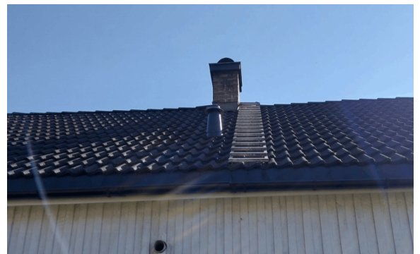
Opplyst luftehett fra 2006, er ikke tilkoblet for utlufting av kloakk pr i dag.
