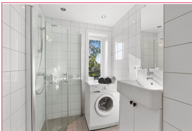
Badet er utstyrt med dusjhjørne med innfellbare dusjdører og blandebatteri fra Hansgrohe.
