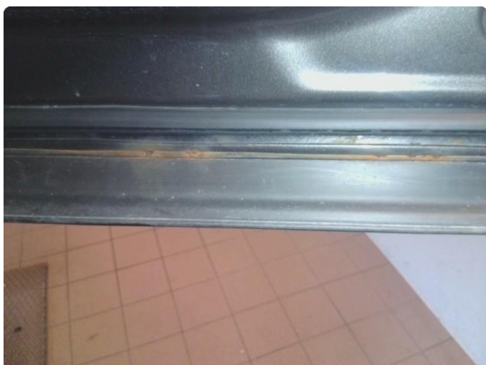
2.3 Rust i fals
