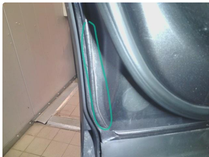
2.2 Rust i fals
