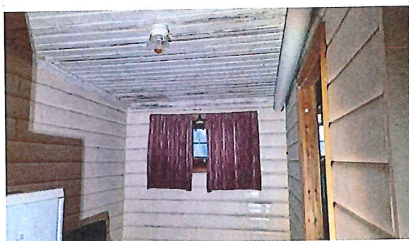
Store fuktskader innvendig.
