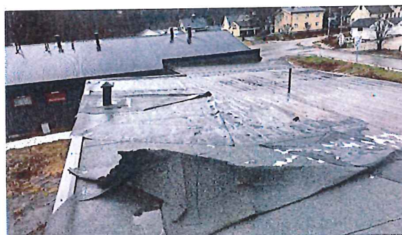
Deler av taket er blåst av. Løs takpapp er senere fjernet.
