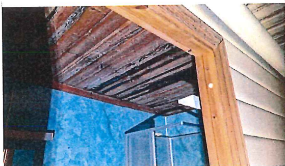
Store fuktskader innvendig.
