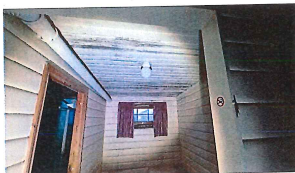
Store fuktskader innvendig.
