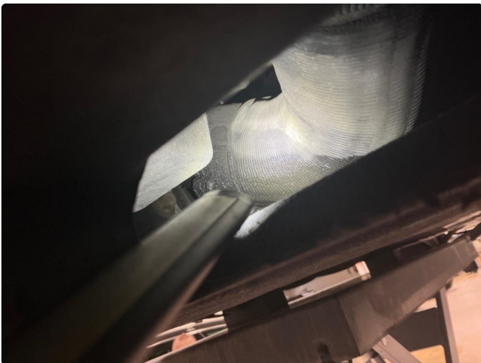
2.1 Noe svetteing fra underside motor
