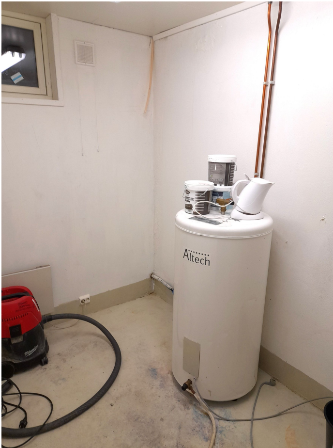
Vaskerom/bod i underetasje. Her står også varmtvannsbereder på 200l, fra 2009.
