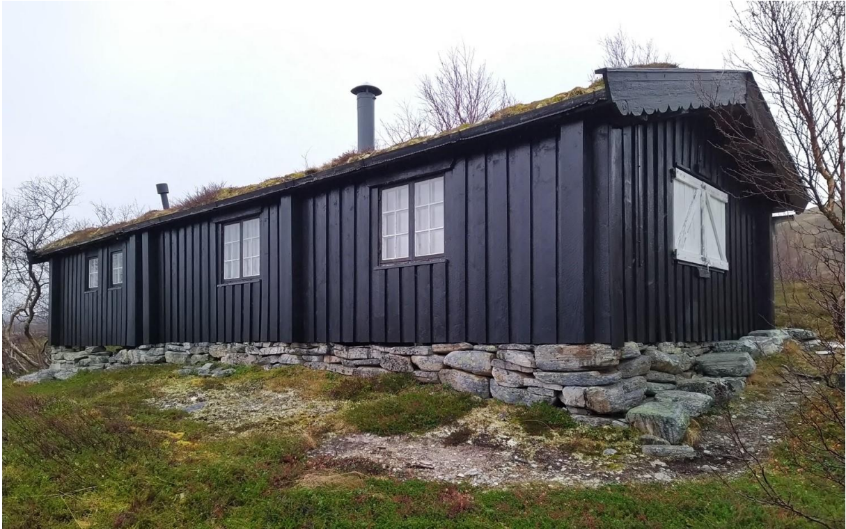
Hytta sett fra nordvest. Tre av tømmerveggene er kledd med beiset panel. Skodder verner vinduet mot vest når hytta ikke er i bruk. Pipe fra ovn på taket i forgrunnen og lufterør/ventilasjon fra kompostdo til venstre.
