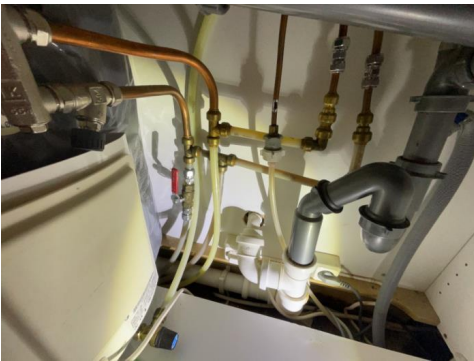
Varmtvannstank - til venstre.
