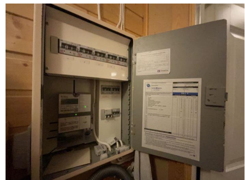
Elektrofordeler - plassert på bod.
