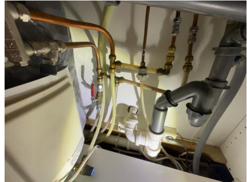
Stengeventil i kjøkkenbenk. Utsnitt av røropplegg.
