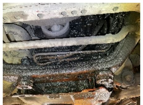
60. Utvendig tilstand motor
