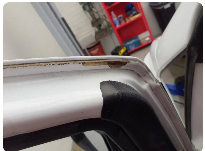
3.1 Øvrige feil Generelt mye riper, bulker, rust og noe steinsprut på hele bilen
