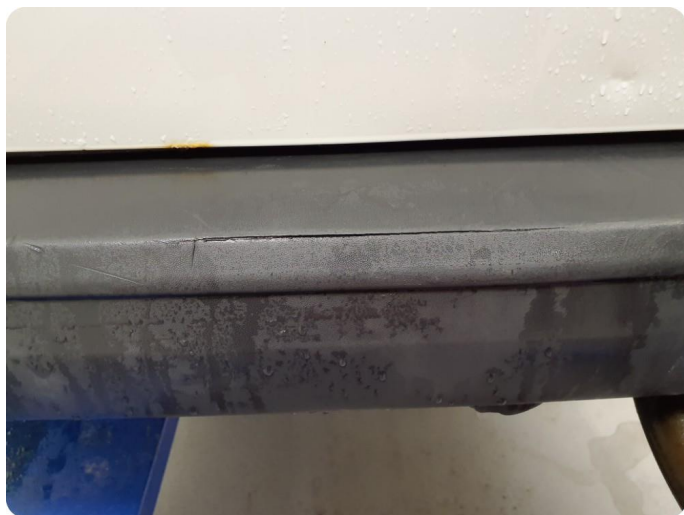
1.7 Ripe(r) ned til grunning
