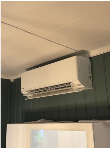
Varmepumpe installert i 2023 av Elektrikern AS
