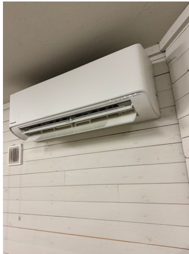
Varmepumpe i garasje.
