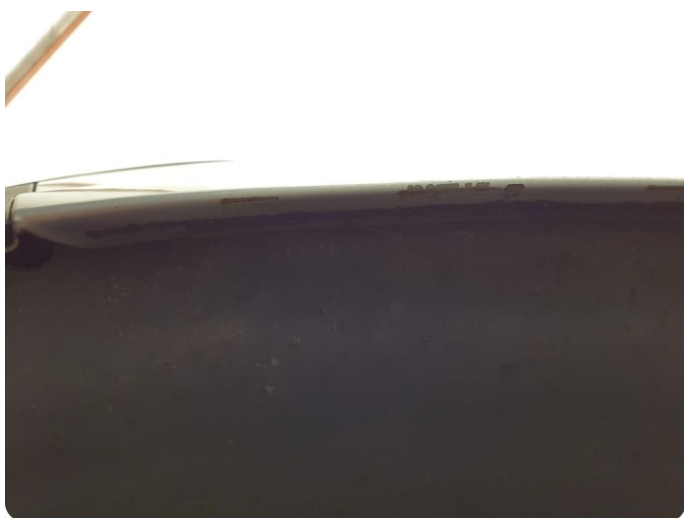
2.3 Rust Inkluderer flere riper
