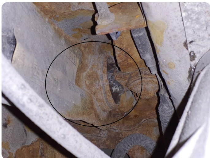
4.1 Utslitt bæreforing Fremre foringer
