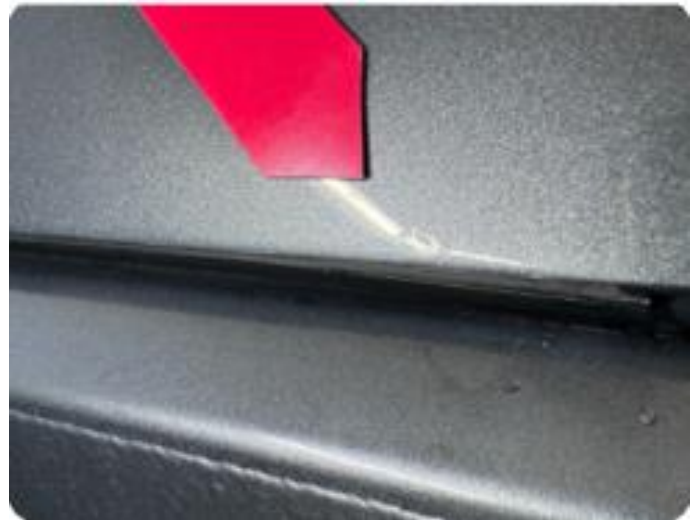
1.1 Noe riper innsteg venstre bak, Noe korrosjon og småbulker på alle dører, Korrosjon mellom fanger og bakskjerm begge sider, Korrosjon venstre bakskjerm.
